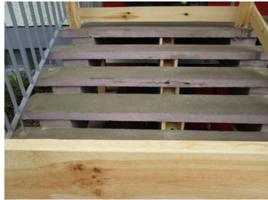
Schäden an den Betonstufen
