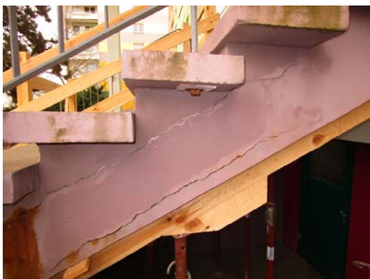
Schäden an der Treppenwange
